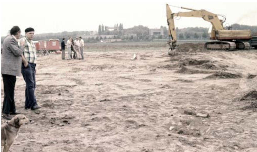
Afb. 3.7 De westelijke helft van het opgravingssterrein tijdens de egaliseringswerkzaamheden, waarbij de grond met een JCB rupskraan werd afgegraven en direct met vrachtauto's werd afgevoerd. Opname in zuidwestelijke richting met rechts op de voorgrond enkele stenen blokken die mogelijk zijn te identificeren met de buiten de rechthoekige omheining gedocumenteerde, min of meer vierkante sporen (cf. afb. 5.4); op de achtergrond zijn de contouren van de sluisen in het Julianakanaal zichtbaar (foto: E. van Geel).
